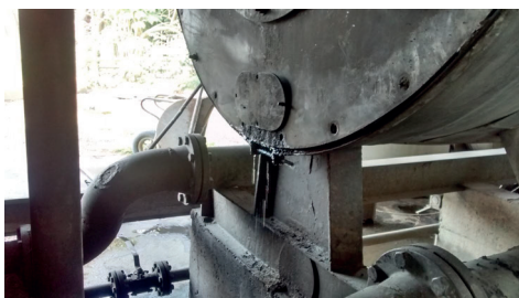
Imagem 07 Corpo de caldeira em condições precárias e com vazamento. (fonte: próprio autor)
