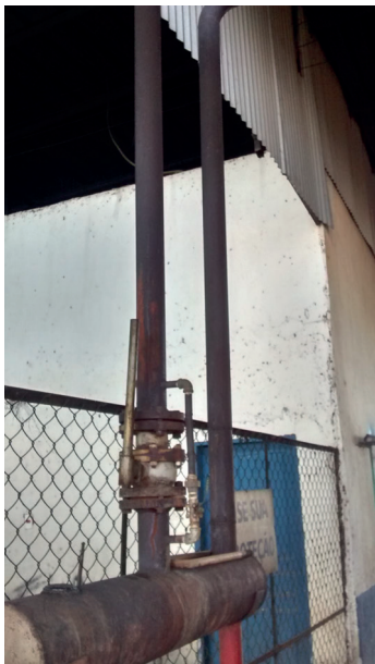
Imagem 06 Tubulação de vapor das caldeiras sem isolamento térmico. (fonte: próprio autor)
