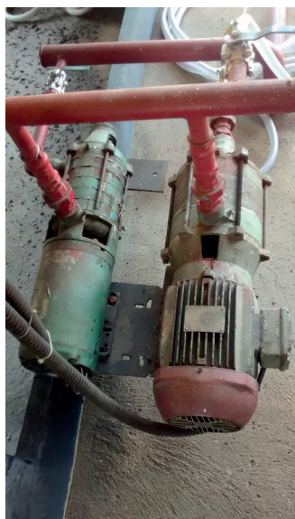
Imagem 08 Sistema de bombeamento para caldeiras com redundância ineficiente (capacidade de bombas diferentes). (fonte: próprio autor)
