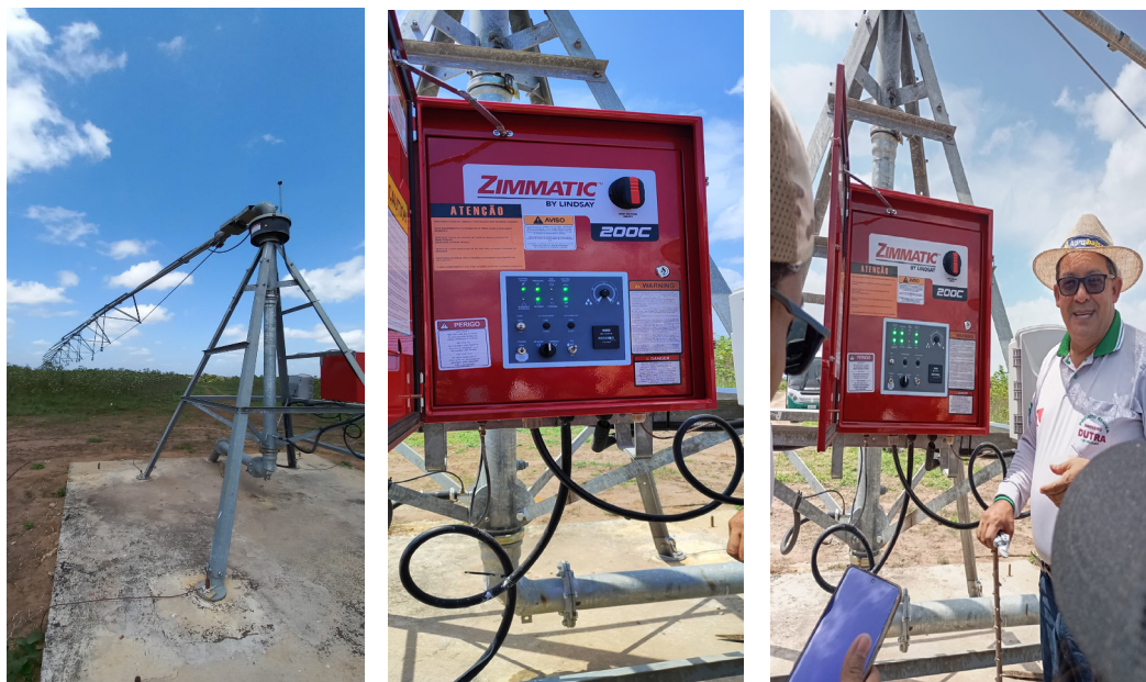
Figura 5 - Sistema de irrigação pivô central e painel de controle do pivô, Tracuateua – PA, 2024.
