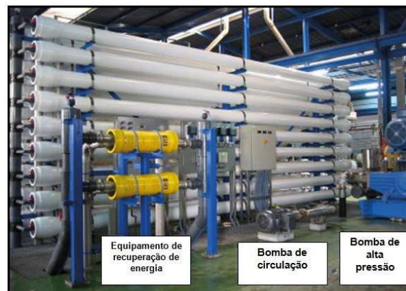
Figura 3 – Sistema de osmose reversa e recuperação de energia
