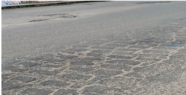
FIGURA 8: Registro de danos na capa asfáltica em Agosto/2021
